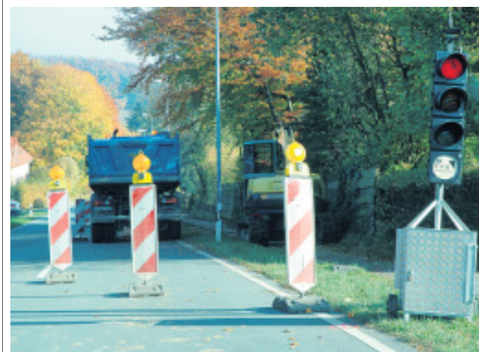
Arbeiten haben begonnen: Die alten Gehwegplatten sind seit gestern Geschichte, der Radweg an der Osningstraße wird neu ausgebaut und mit einer Asphaltdecke versehen. FOTO: A. HANNEFORTH
