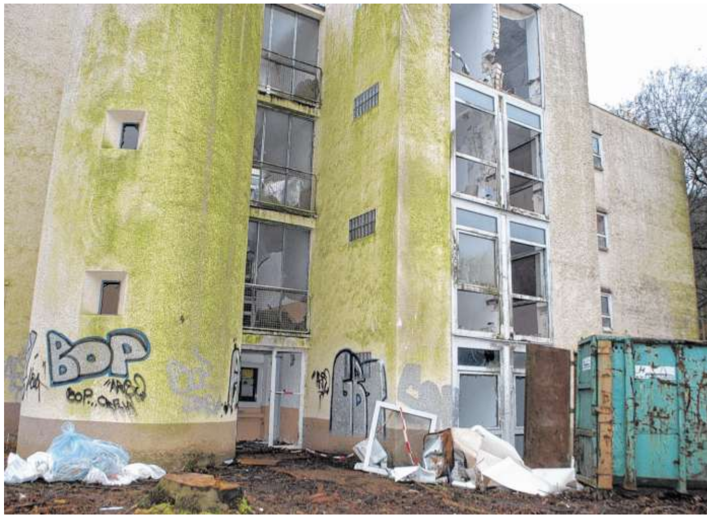
Manchmal muss es erst schlimmer werden, bevor es besser wird: Der Abriss der Wohnblöcke an der Weststraße 42 und 46 zieht sich hin. Die aufwendige Asbestentsorgung hat den Zeitplan von sechs Wochen für die Abrissarbeiten zunichte gemacht. FOTO: K. SPIEKER
