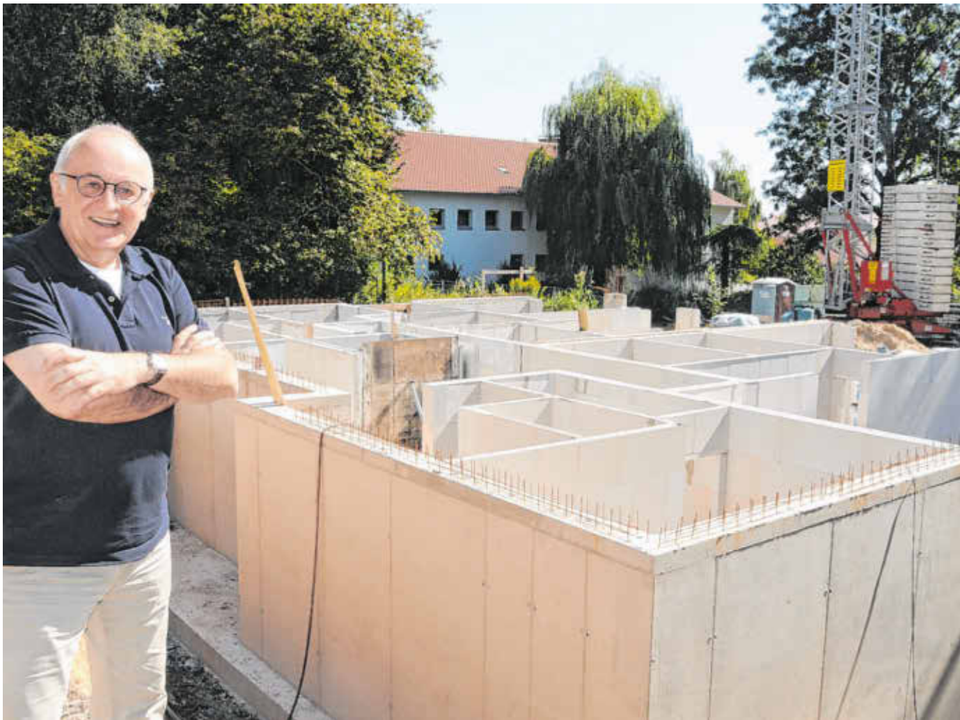
Grundmauern stehen bereits: Investor Udo Heidemann lässt auf einem bisher freien Grundstück zwischen Stadtpark und Venghauss-Platz ein Mehrfamilienhaus errichten. Noch vor Einbruch des Winters soll der Rohbau fertig sein.
