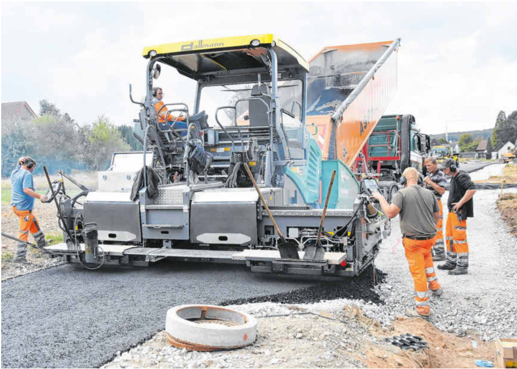
Eine heiße Angelegenheit: Im neuen Gewerbegebiet Rodderheide asphaltiert die Firma Dallmann derzeit die Baustraße. Insgesamt rund ein Kilometer Fahrbahn entsteht innerhalb von zwei Arbeitstagen. Heute Nachmittag soll das Werk bereits beendet sein.
