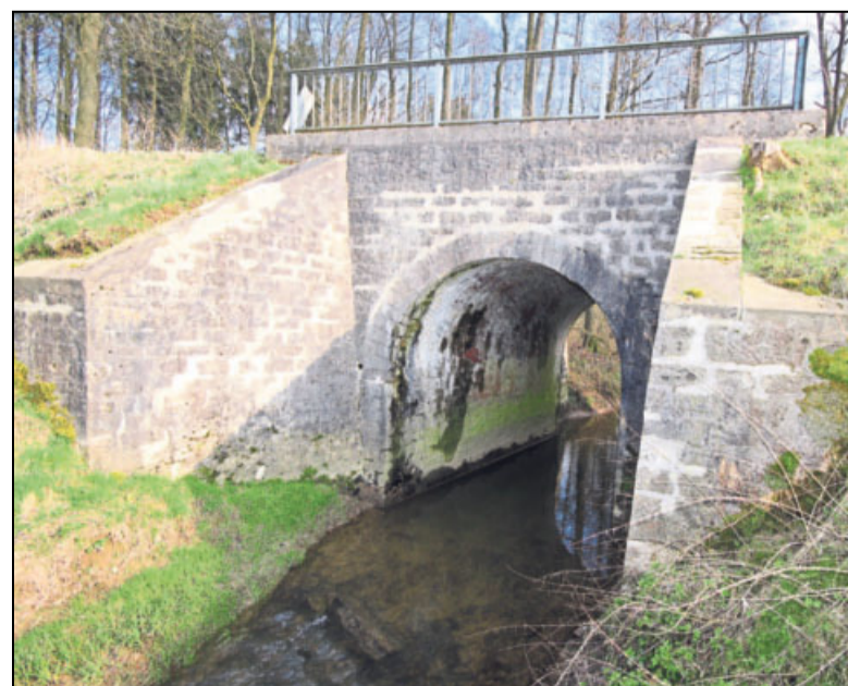
Die Brücke über die Warmenau an der Rotenhagener Straße ist in die Jahre gekommen. Um die Belastbarkeit nicht auszureizen soll jetzt eine Geschwindigkeitsbeschränkung auf 50 Kilometer pro Stunde verordnet werden. Foto: Klaus-Peter Schillig
