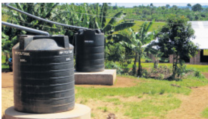
Ein wertvolles Gut: Das Wasser, das in der Schule verbraucht wird, wird in diesen Tanks gelagert.
